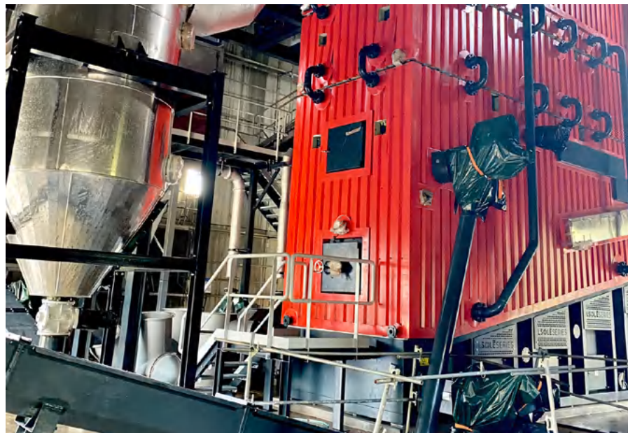
La chaudière biomasse Grapsud financée grâce à la compensation carbone
