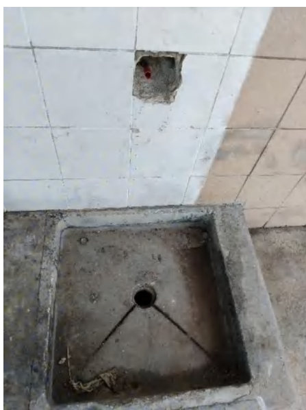
Dégradation robinets extérieurs
