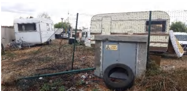
Coffret électrique piraté
